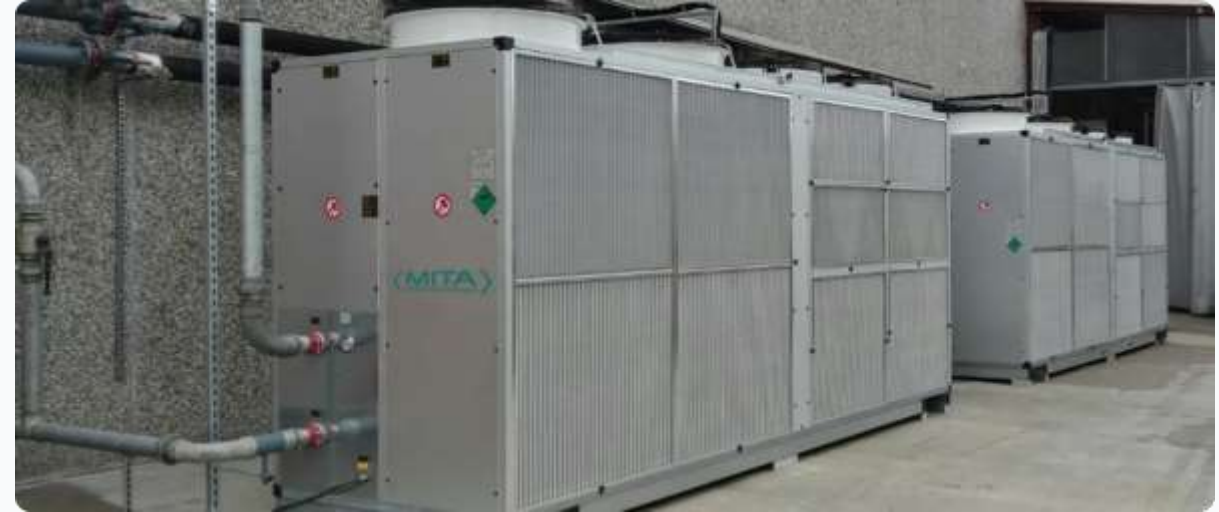
Échangeurs de chaleur industriels (dry coolers)
