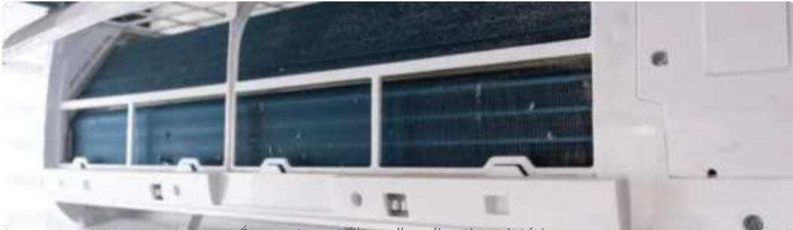
Évaporateur et filtres d'un climatiseur intérieur
