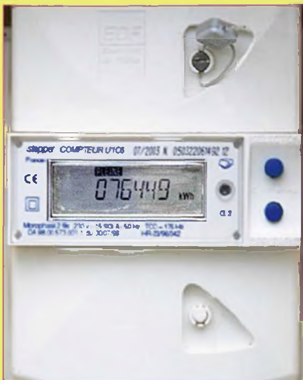
Fig. 1 Indication du compteur au 1 er janvier 2011
